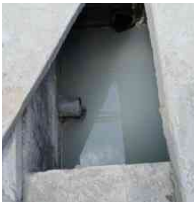
Vị trí bể trung gian sau bể tách mỡ của nước thải nhà ăn
