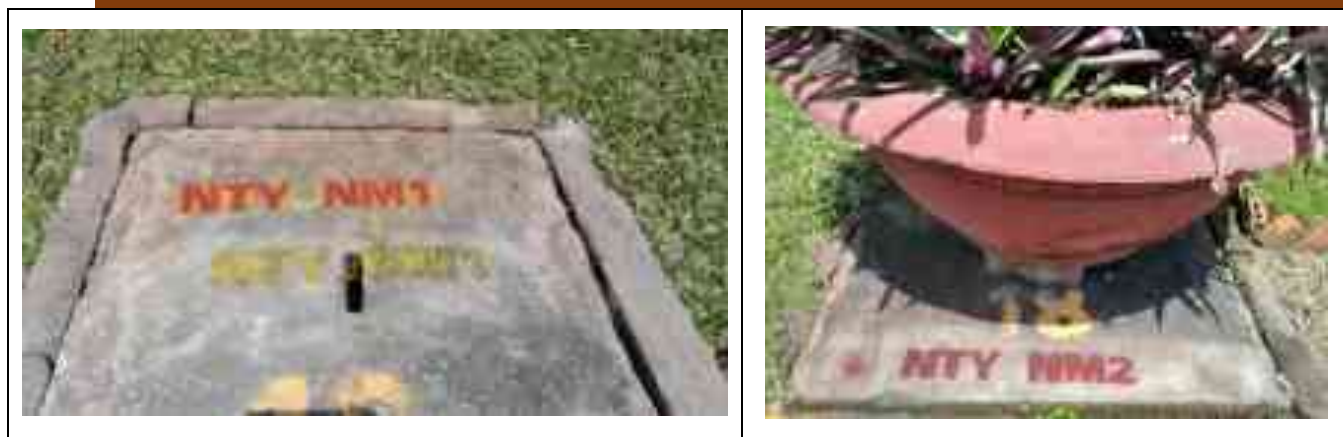
Hình 3. 2. Hồ ga đấu nối nước mưa tại Nhà máy
